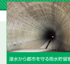
浸水から都市を守る雨水貯留管
